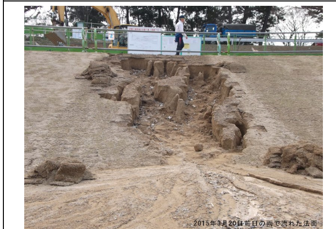
日野工区で芝張り直後の雨で法面崩壊した。
