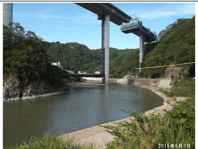
豊水期を迎え河川工事が止まっても新名神の工事は続く
