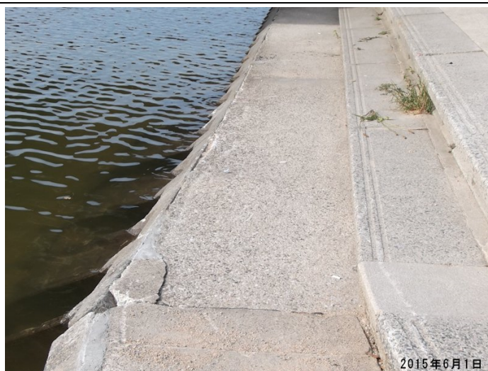
阪神橋梁護岸の復旧区間との取り合い部分に残る傷跡
