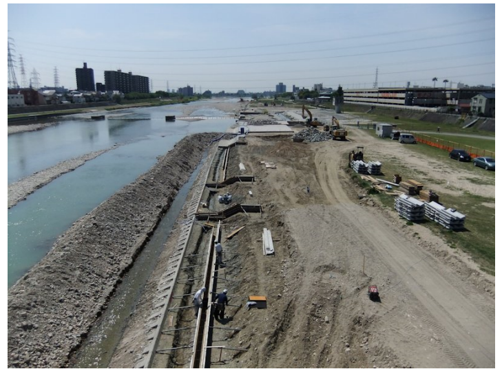
②武庫川新橋下流復旧工事 鉄筋無し?のコンクリート
