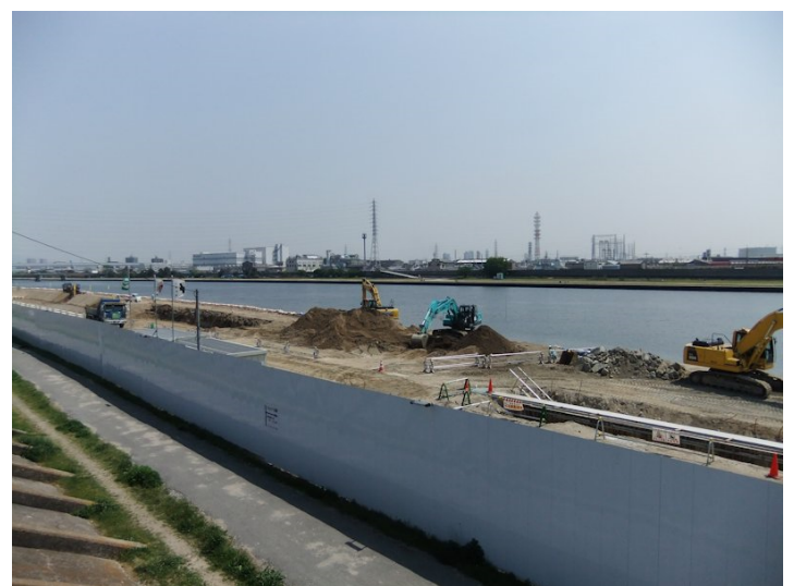
⑥掘削土砂は台船で運搬される計画なのにトラック運搬
