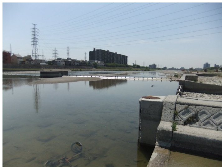
③百軒樋の堰が倒され百軒樋は取水出来ていない。
