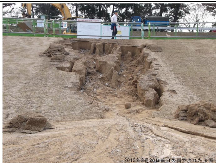
2015年3月20日前日の雨で法面崩壊した。
