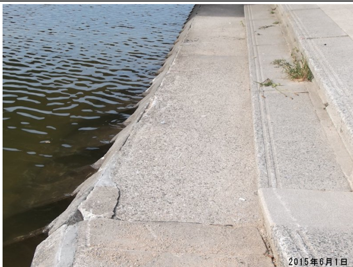
阪神橋梁護岸の復旧区間との取り合い部分に残る傷跡
