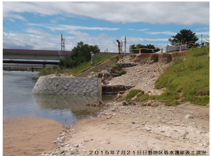
2015年7月21日日野地区低水護岸表土流出
