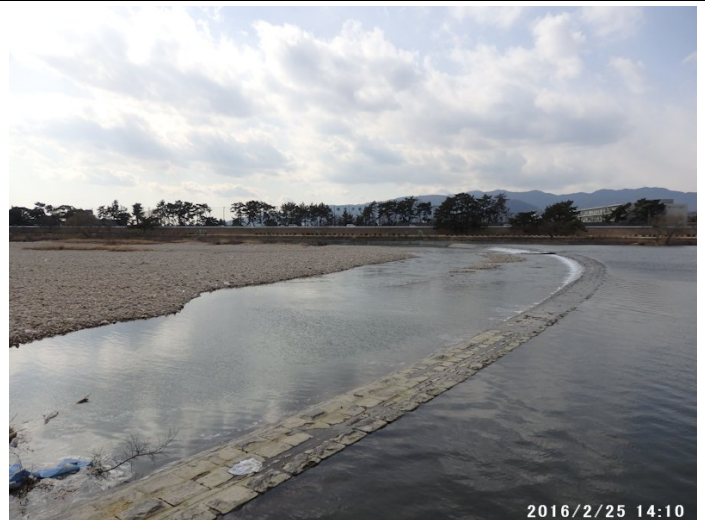
7号堰（根固め工事は終わったが土砂堆積が激しい）
