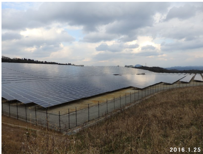
池尻川源流の採石場跡地に太陽光発電パネル設置状況
