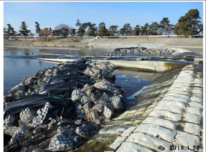
2号堰に袋型根固め材が積み上がられていた。
