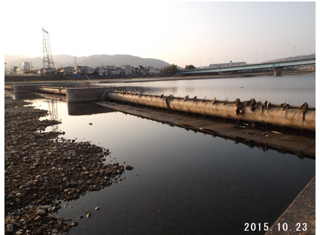
堰下流側の湧水が僅かに流れている
