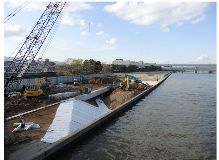
小松工区矢板護岸工事現場で掘削作業が始まっていた
