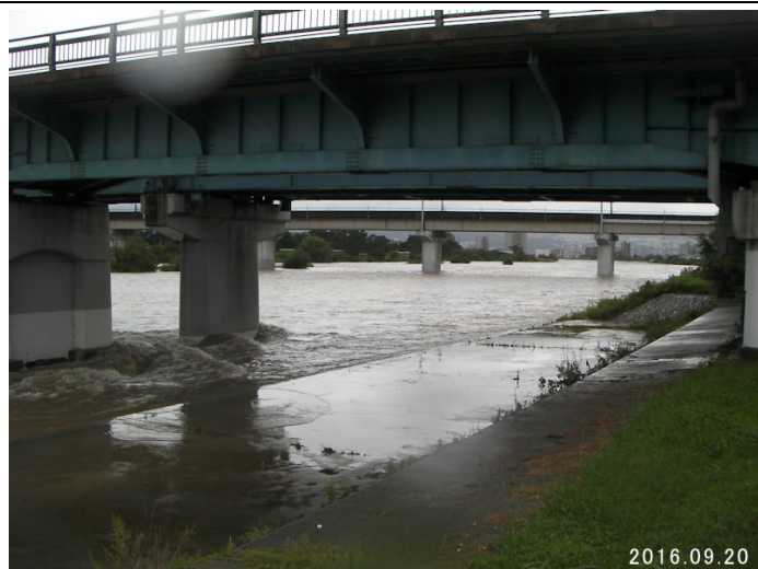
16号台風の出水は砂州の影響か挺水護岸に達した。
