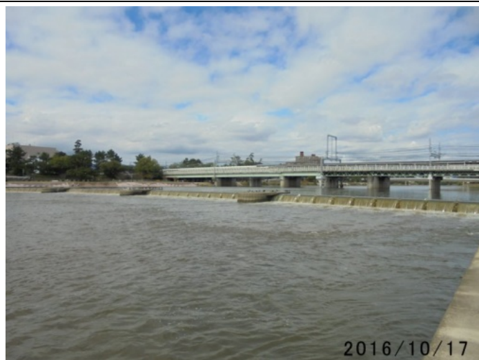
潮止め堰全門最高位に引き上げられ正常制御状態である。
