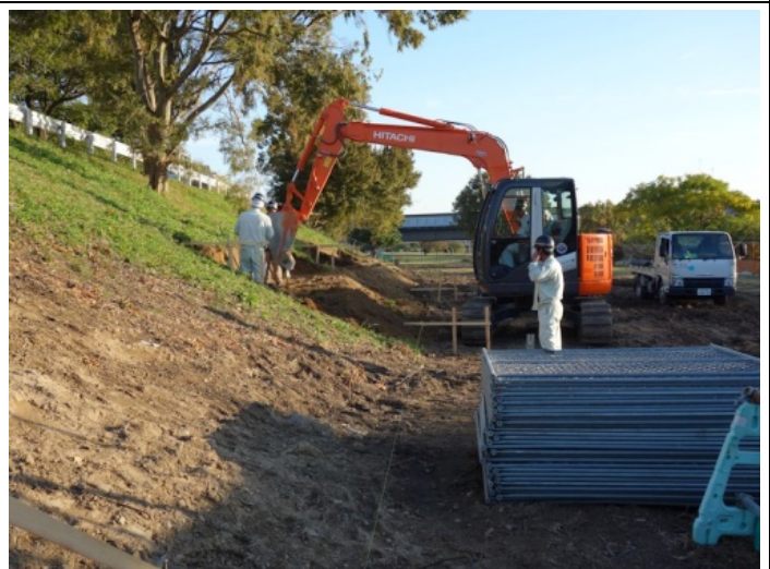
法面の木が切り倒されコンクリートマット工事始まる。
