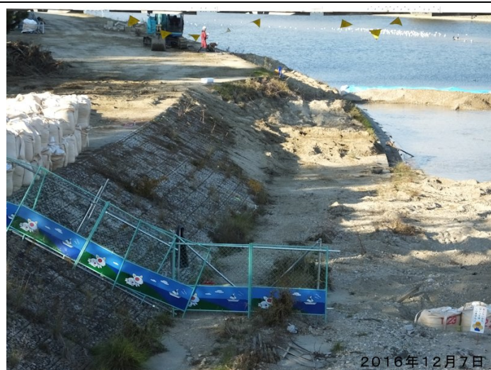
小松工区工事現場 矢板打ちと低水護岸掘削作業始まる。
