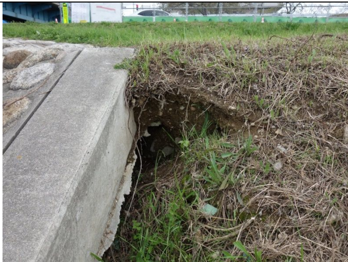
武庫橋下流側左岸で見つかった空洞外観
