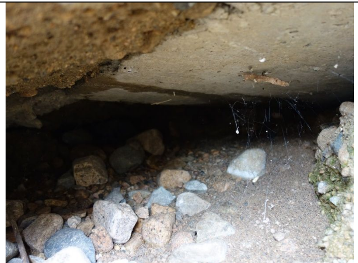
相当量流出で出来た空洞内部の様子。
