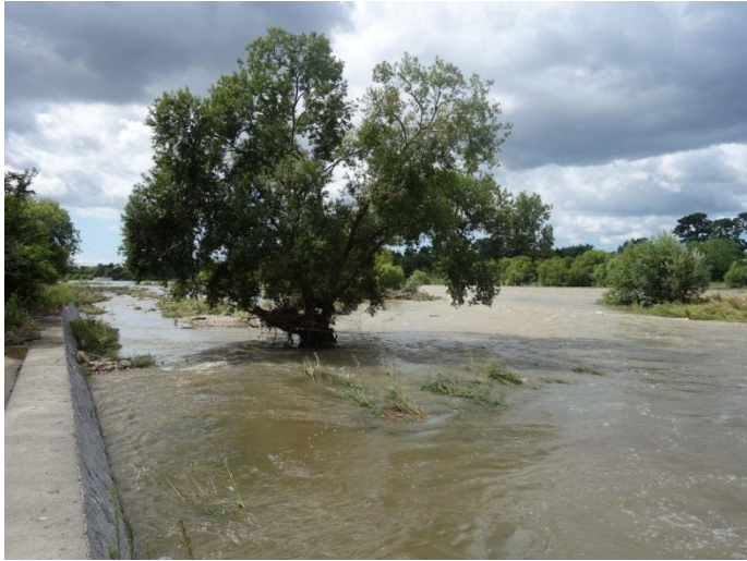
9月18日台風18号の後の甲武橋第6堰下流側付
