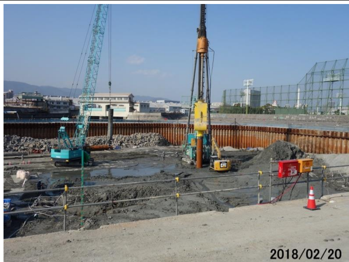
今津水門の杭打ち工事。軟弱地盤で短時間で入っていく
