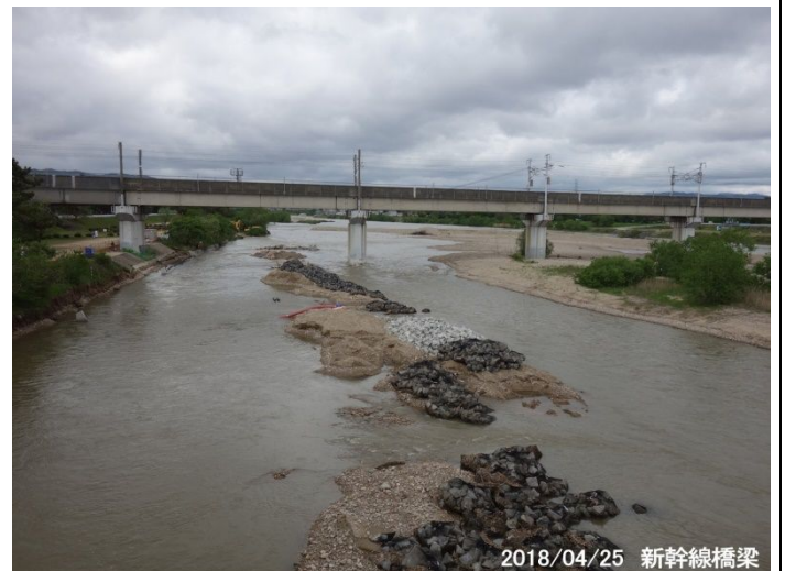
24～25日間の降雨後の状況。工事中断していた。
