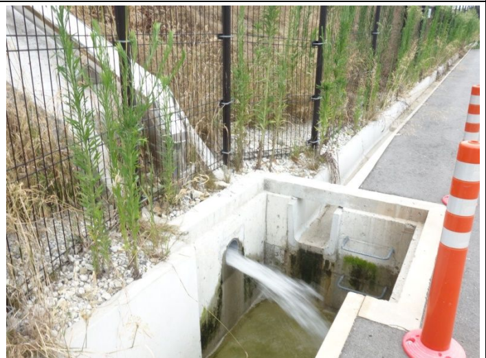
調整池③に入る浄化槽排水管
