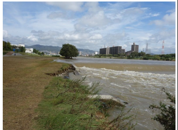
六桶堰上流側高水敷を洪水がながれ、昨年復旧した護岸崩れた
