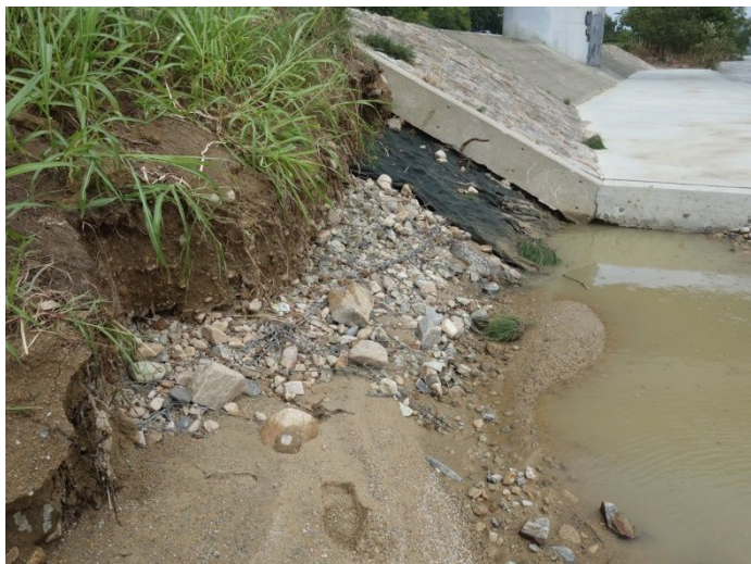
新幹線橋梁したの犬走り表土洗われ表土流失
