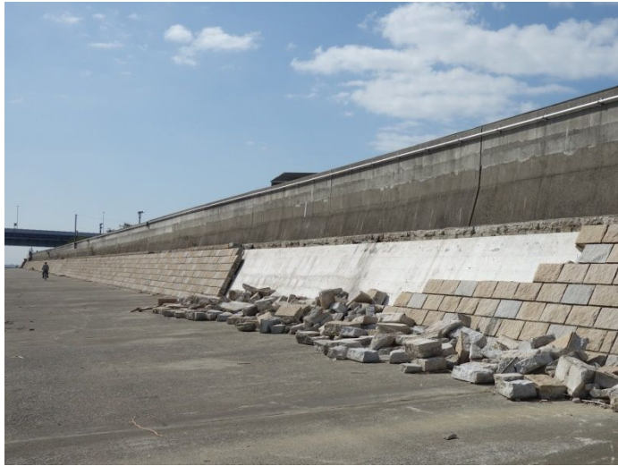
崩れた護岸表張り（右岸河口付近）
