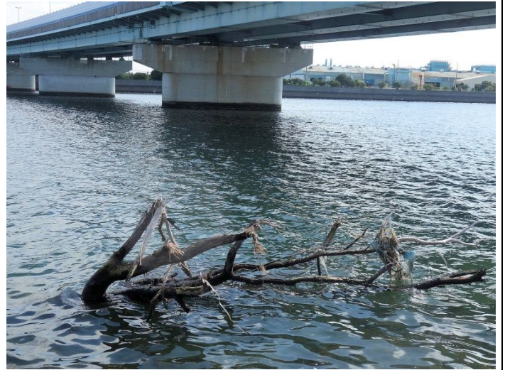
湾岸線橋梁まで流れ着いた流木
