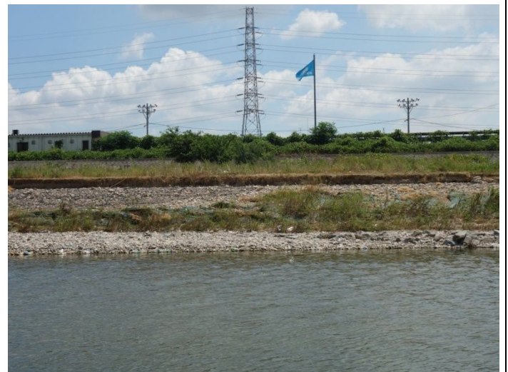
動物愛護センター付近の、表土が剥ぎ取られた低水護岸
