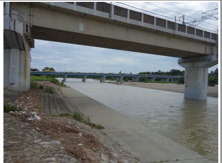
甲武橋水位より高い新幹線橋梁の漂着物痕跡
