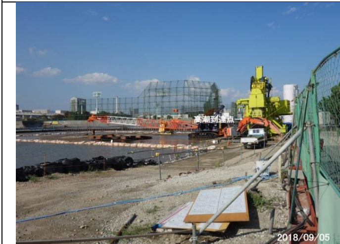
今津水門工事現場高潮に襲われ建設機械水没した。
