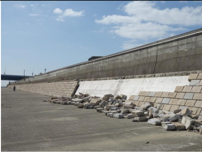
崩れた護岸の表張り（右岸河口付近）
