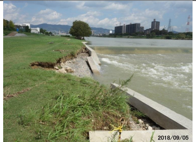
この程度の被害はあったが目立った被害は見かけなかった
