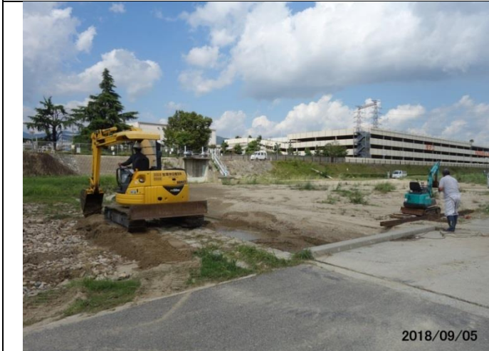
洪水の度に繰り返す掘削、水が上がったら埋まると諦め顔
