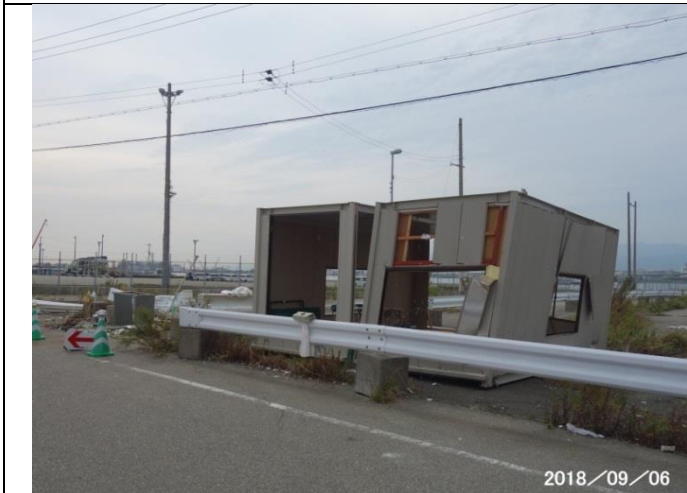
台風21号の強風が仮設事務所を吹き飛ばしてしまった
