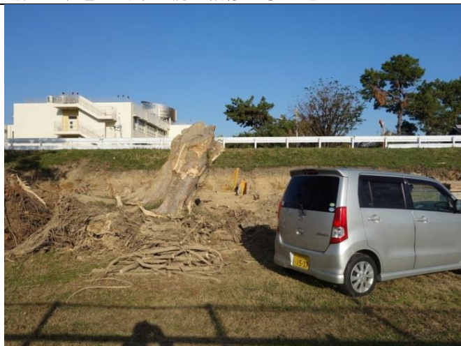
堤防強化工事(大島工区)意外と浅い大木の根。
