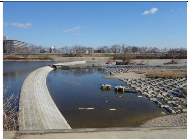
第6堰（甲武橋水位は連日0.6m前後で推移している）
