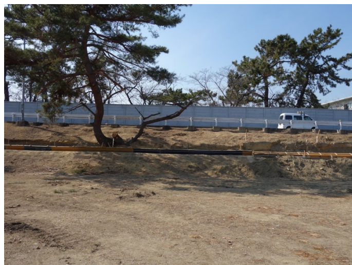
補強工事で松が伐採された。(相当な配慮の跡が偲ばれる)
