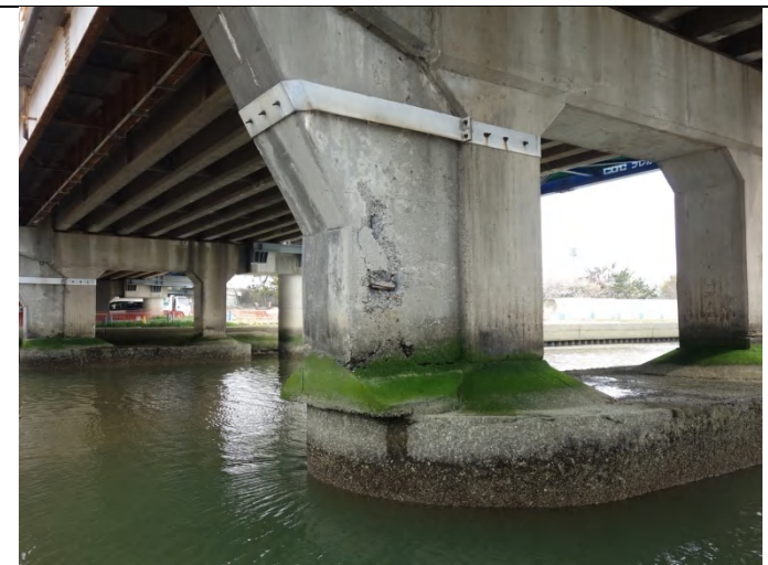
南部橋橋脚の老朽化状況
