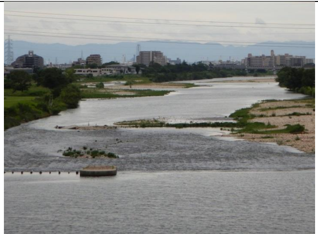
武庫川新橋から見た帯工付近 流れは左岸側に偏っている
