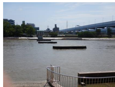
転倒した潮止堰
