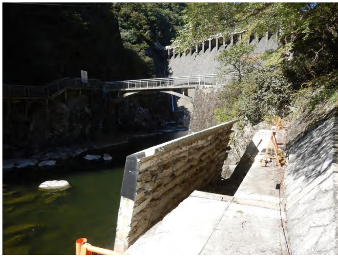
千苅ダム護岸崩壊（10/9）撮影、台風によるものではなさそう
