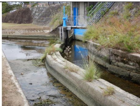
2019年19号台風時の樋門水路
