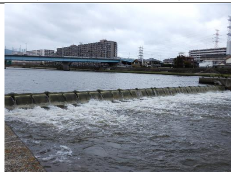
2019年19号台風 百間樋堰転倒状況
