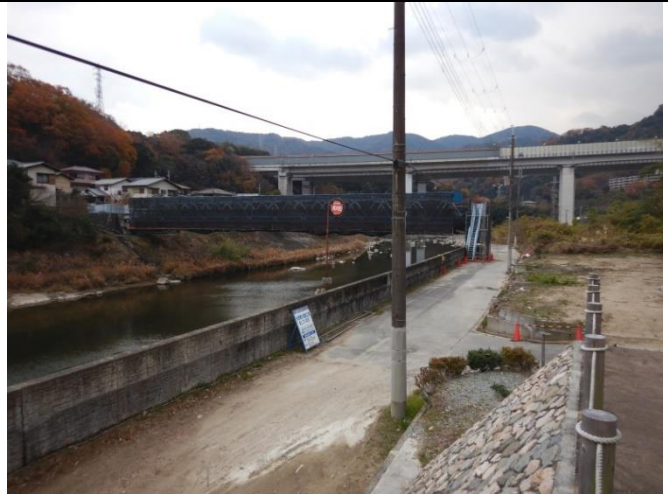
リバーサイド住宅跡地水管橋塗装工事に伴う通行止め
