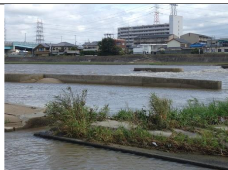
2018年21号台風 百間樋堰転倒状況
