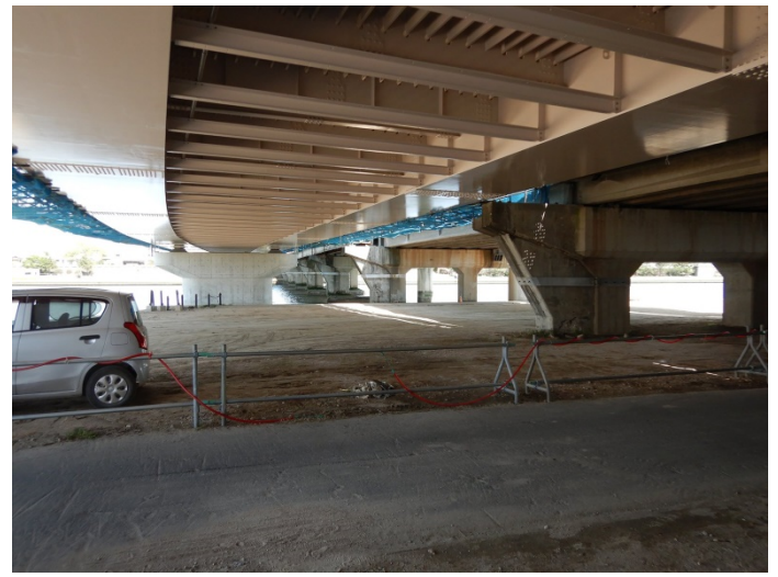
新旧南武橋、道路切り替えが終われば右側の旧橋撤去される。
