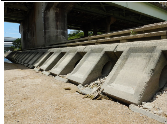
潮止め堰転倒で現れた護岸 (水があればテナガエビの住処)
