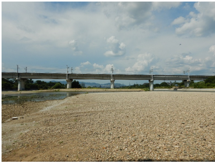
たった3ヵ月で堆積下土砂（新幹線橋梁下流）
