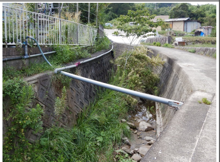
堰上げ方式からパイプ取水になり川の縁が切れた名塩棚田
