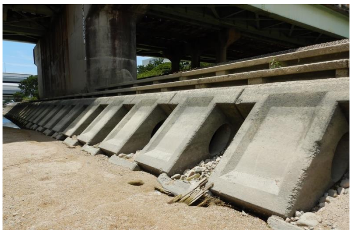
潮止め堰転倒で現れた護岸 (水があればテナガエビの住処)
