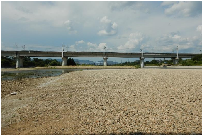
たった3ヵ月で堆積した土砂(新幹線橋梁下流)
