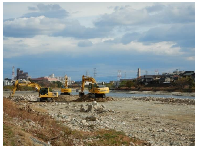
伊子志堰上流河床削
