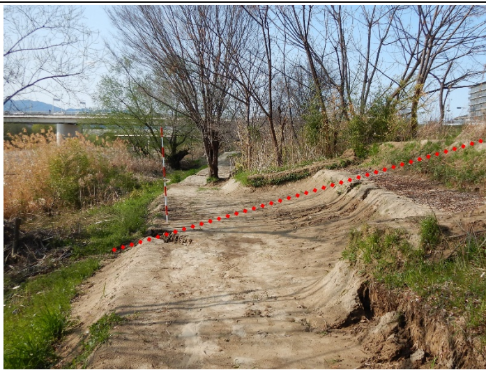
JR 橋梁上流左岸の不法工作（法面削られる）
