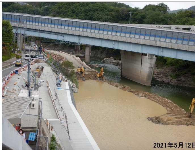
終わり間近の生瀬橋上流側河床掘削+護岸改修工事現場。
