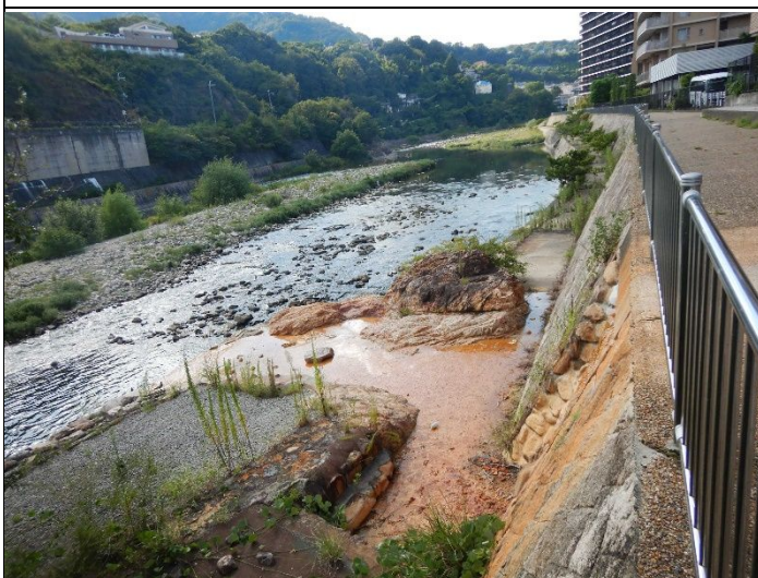
S字橋～生瀬橋間左岸柵で覆われ河原に降りられなくなった
