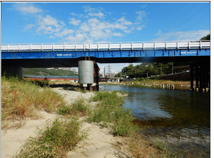
森與橋仮設橋付近の土砂堆積が進んでいる。
