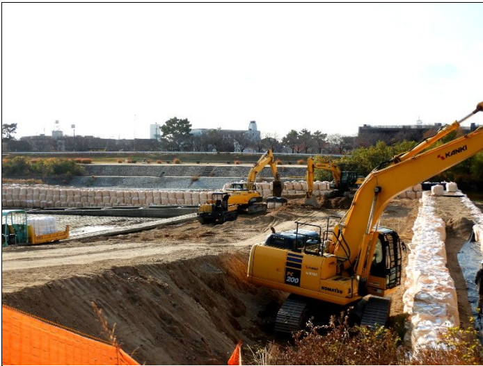
3 堰改修工事現場 熱心に見入る人の姿に関心の深さを感じる
