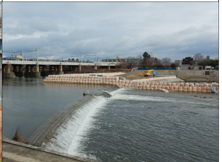
川幅の中程まで堰き止められた 3 号堰改修工事現場。1 月 15 日
