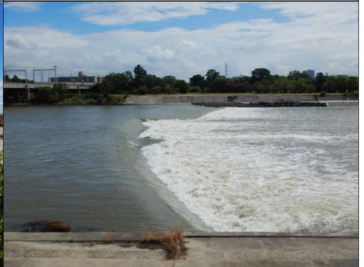
7号台風直後の3号床止め 8月16日
